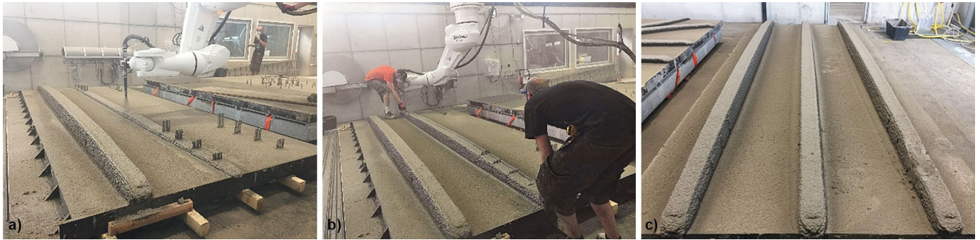
Bild 10 a) Aufdrucken der Rippen, b) Einlegen der Bewehrung, c) Plattenbalkenelement nach dem Überdrucken der Bewehrung a) Printing of the ribs, b) insertion of the reinforcement, c) beam element after printing on the reinforcement
